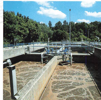
DIE NITRIFIKATIONS- BECKEN
